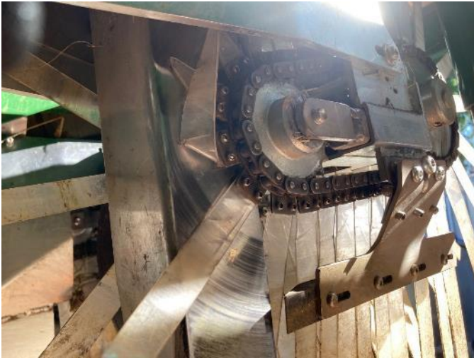
Blockade durch feststeckende Lamelle
