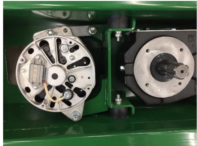
Generator und Getriebe
